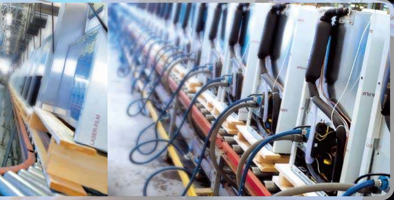
Stazione di collaudo vista interna ed esterna linea 1
