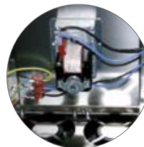
Ventilation des moteurs / Motors ventilation
