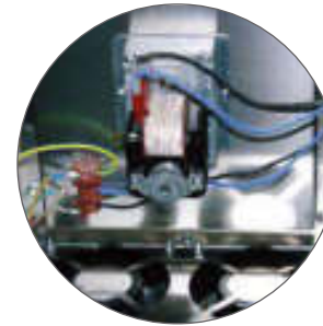
Ventilation des moteurs / Motors ventilation
